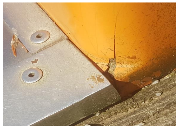
Austausch der Rutsche auf Grund eines Risses (Sicherheitsauflage)
